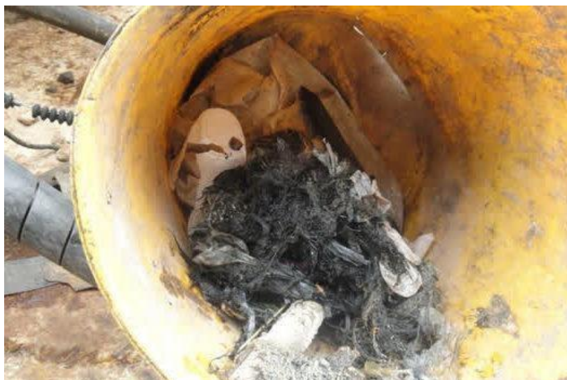
Figura 2 – Entupimento em ramal de esgoto com acúmulo de resíduos.
