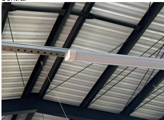
Figura 28. Luminária de Sobrepor do Espaço Central
