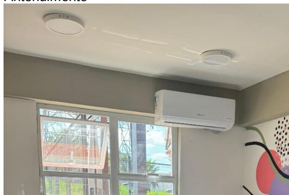
Figura 29. Luminária Spots Salas de Atendimento
