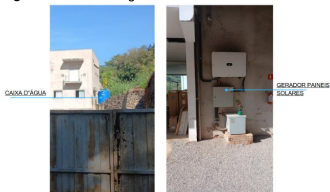
Figura 44. Caixa D'água e Gerador de Painéis Solares.
