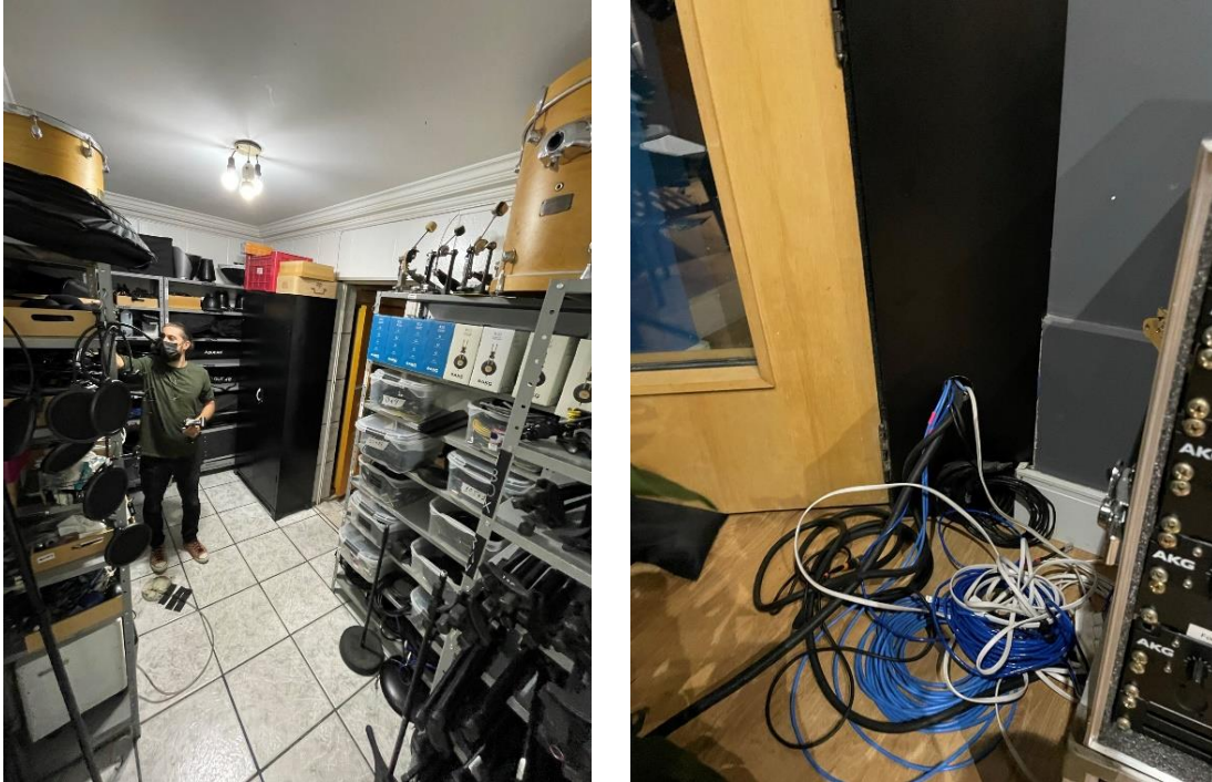
Figura 11 - A. Depósito – Locker), B. Cabos vindo do locker por dentro da parede)
