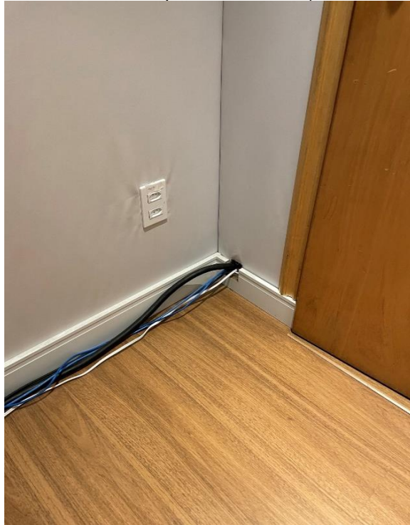
Figura 14 - Detalhe como os cabos chegam do locker para sala técnica)
